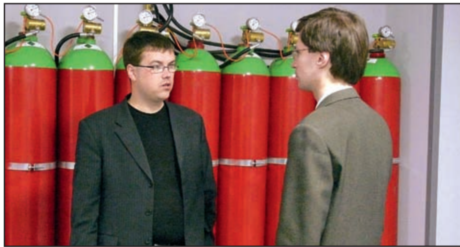
Современная система пожаротушения в ИЦ ОАО «Уралсвязьинформ» в стадии готовности.
